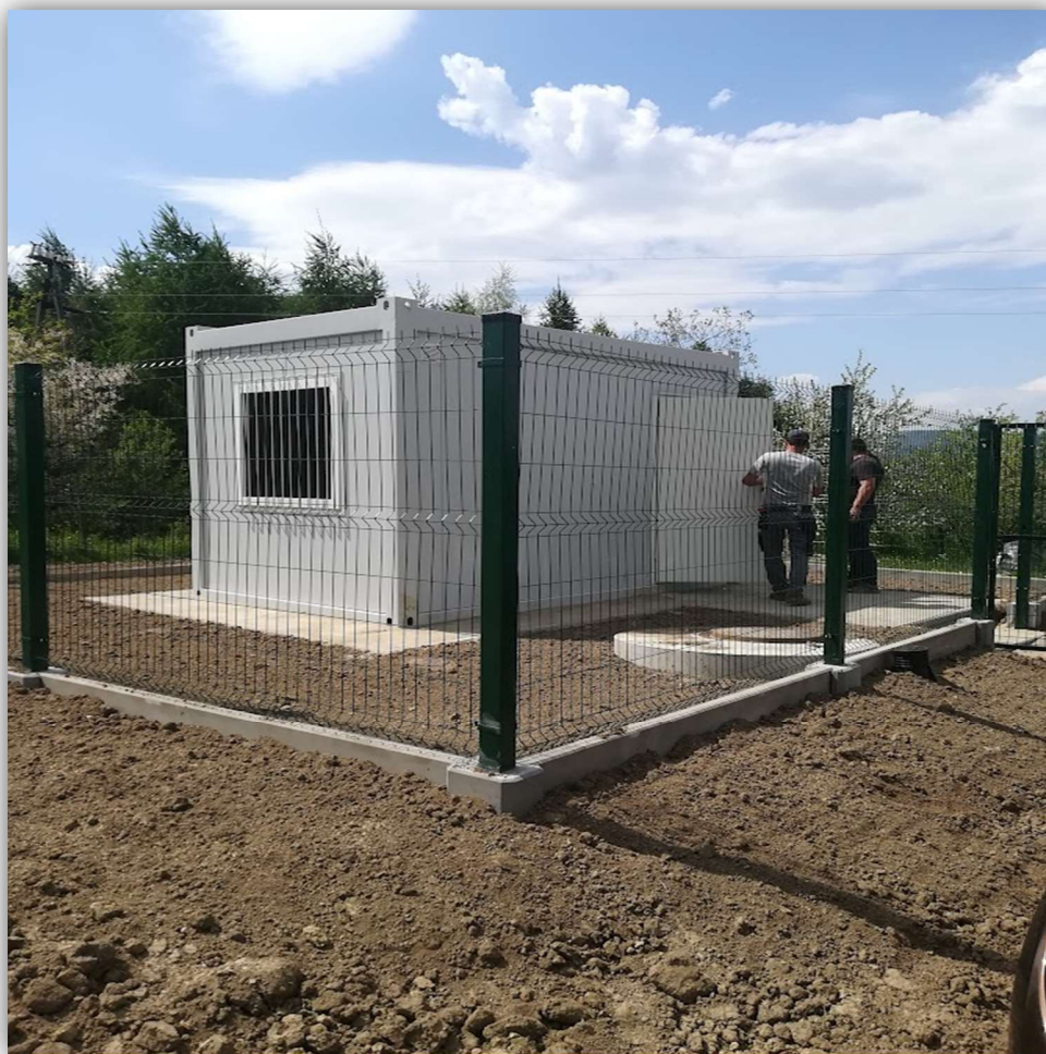
Hydrofornia kontenerowa w Bukowej.
