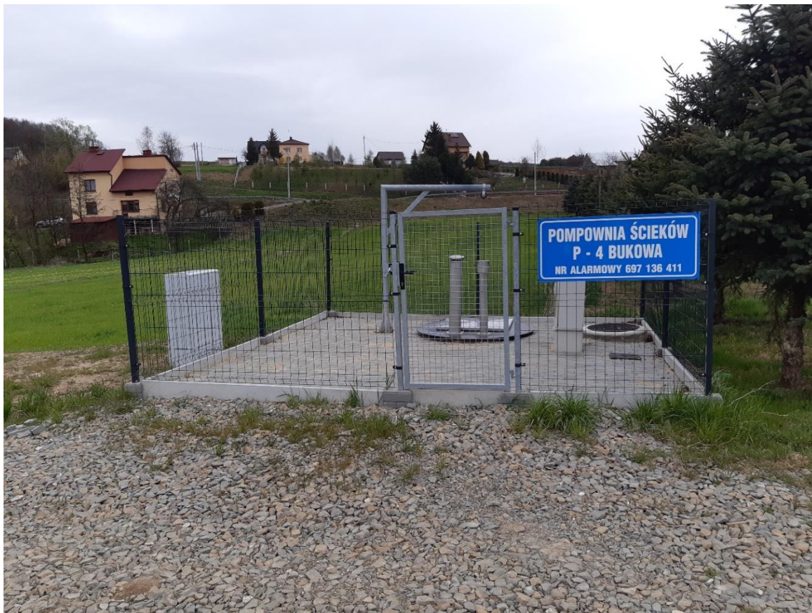
Rysunek 30 Pompownia ścieków P4 na działce nr ewid. 88/21 w Bukowej.
