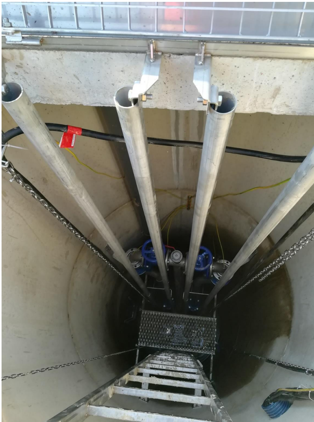
Rysunek 28 Przepompownia ścieków P2 na działce nr ewid. 488/5, zmodernizowana w ramach budowy kanalizacji sanitarnej w miejscowości Brzostek dla ul. Polnej, Przedmieście, 11-go Listopada, Szkotnia (wyposażenie wewnętrzne).
